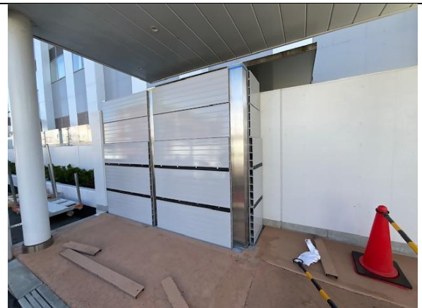
感染症入口防水板設置後
